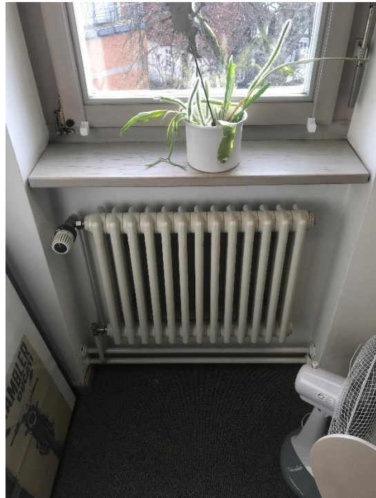
Rippenheizkörper im Büro
