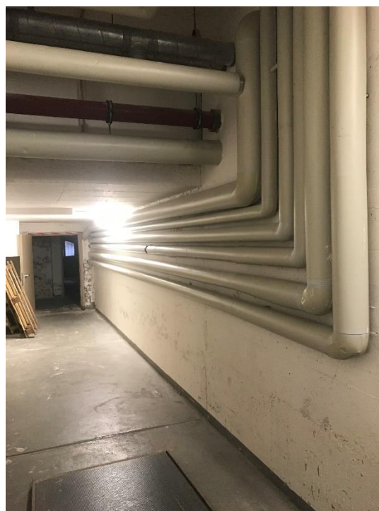
Rohrnetz im Kellergeschoss
