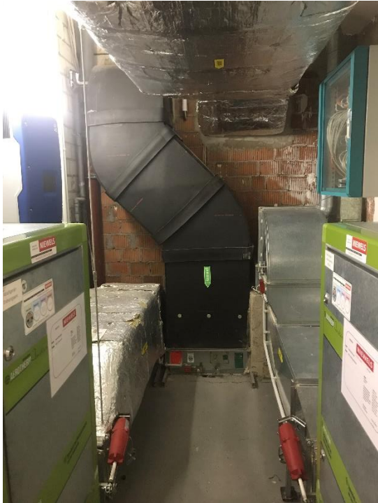
Abluftanlagen „Ordnungsamt & Nebenräume“
