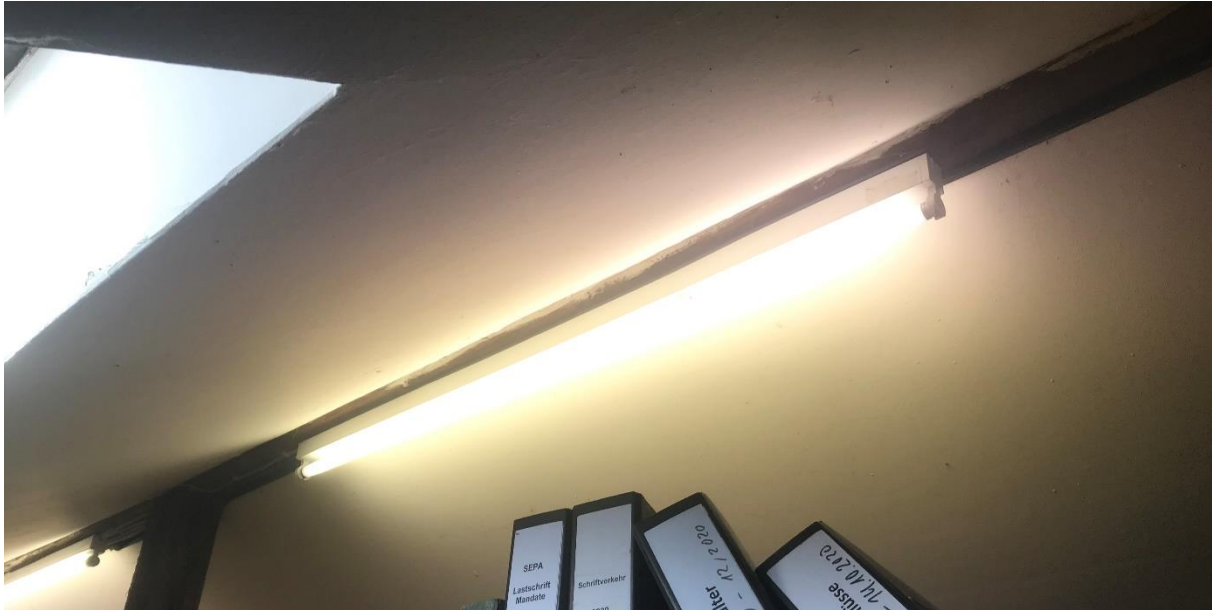
Leuchtstofflampe im Lager DG Altbau
