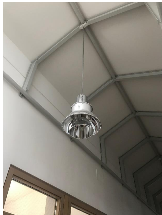
Kompaktleuchtstofflampe im Flur
