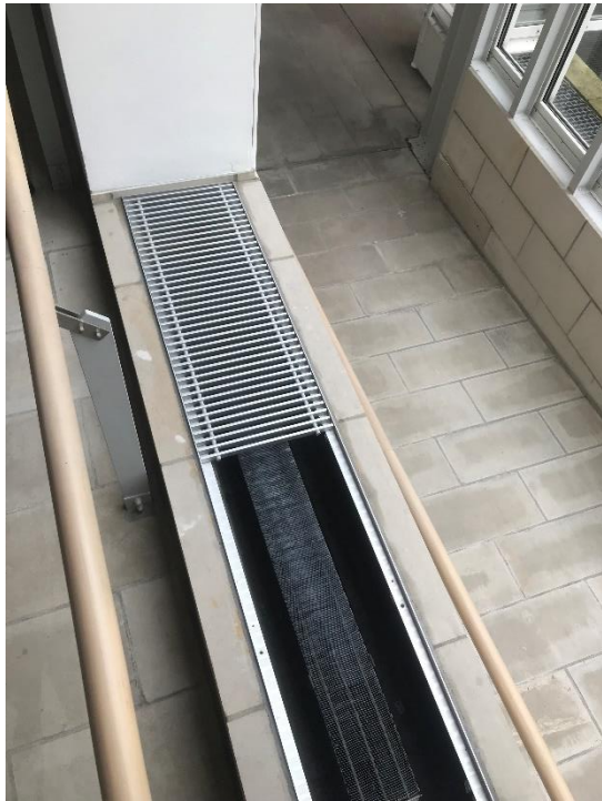
Bodenkanalheizkörper im Foyer
