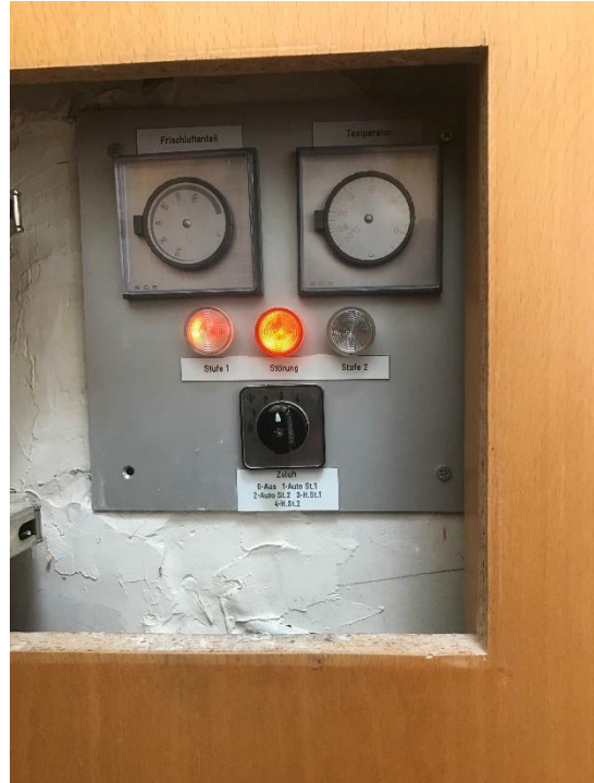
Steuerfeld Anlage „Große Fraktion“
