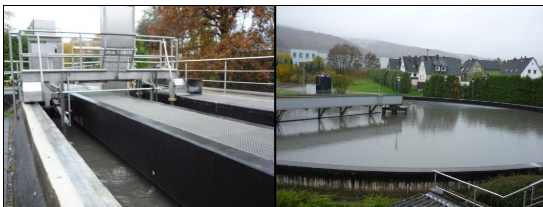
Abbildung 2-3: Sandfang und Vorklärbecken GKW Bad Pyrmont-Lügde
