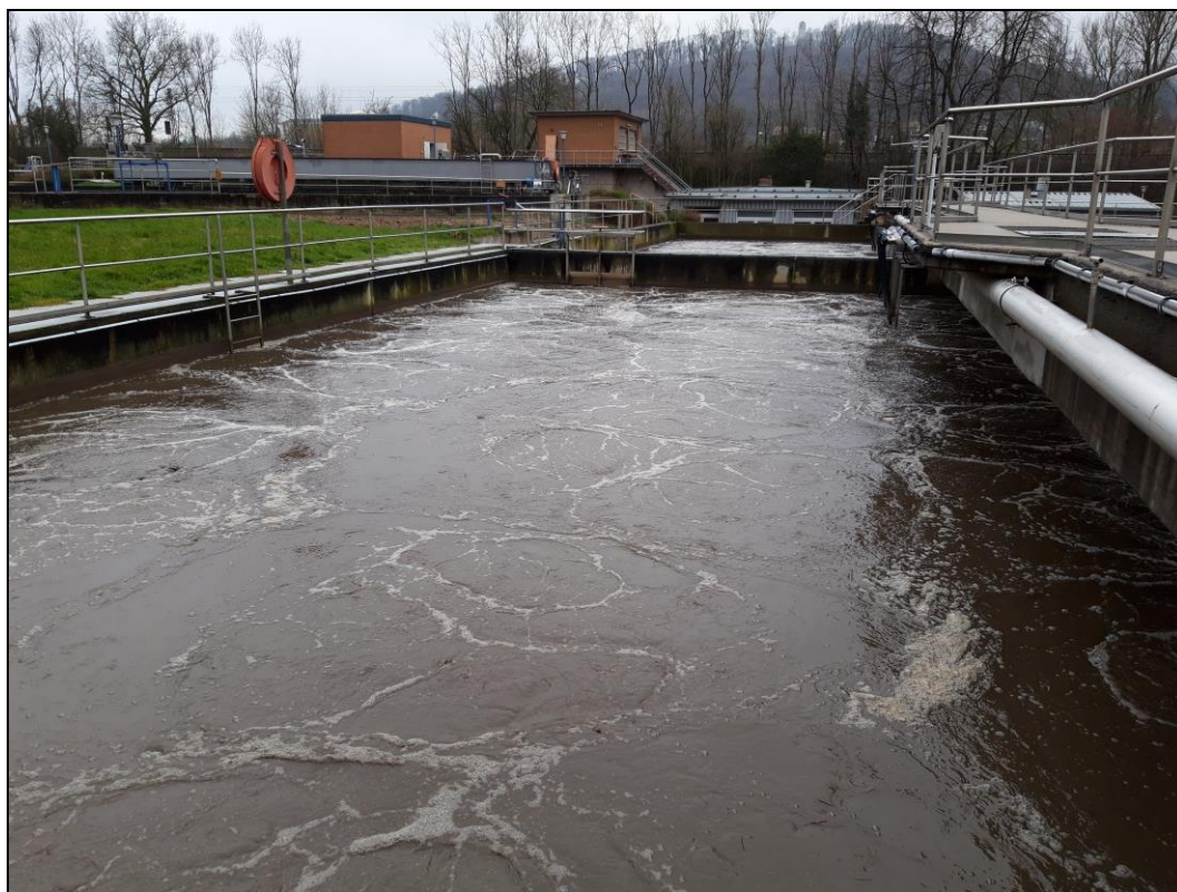
Abbildung 2-5: Belebungsbecken 3/4 GKW Bad Pyrmont-Lügde
