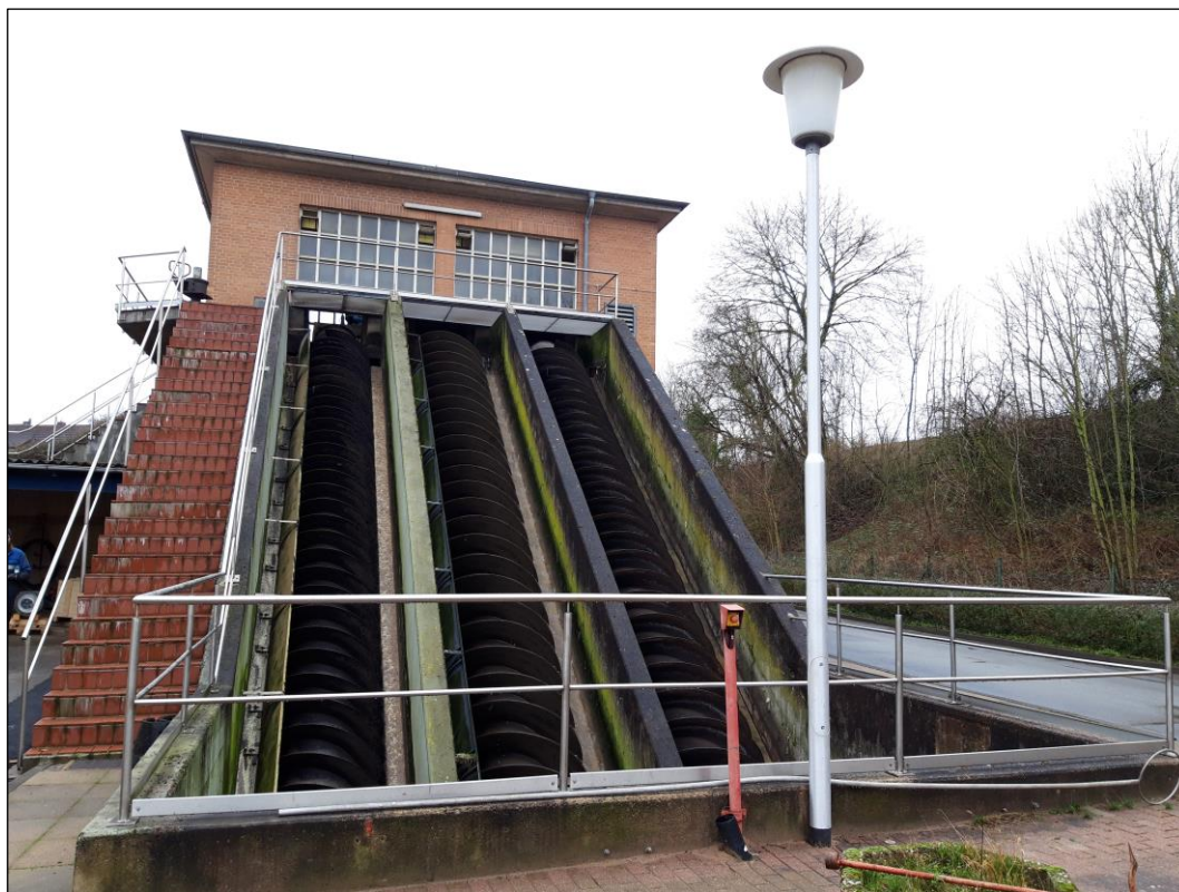
Abbildung 2-2: Zulaufhebewerk GKW Bad Pyrmont-Lügde
